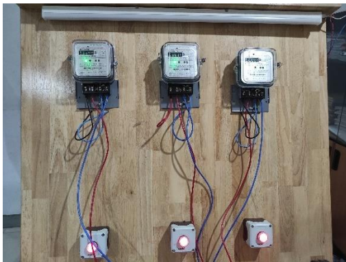
Gambar 1. Papan Praktek dan kWh Meter
